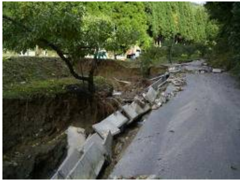
写真1 排水路の流失と根の露出
