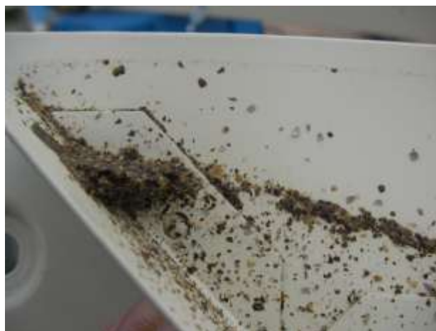
写真4 運転後の循環機下部カバー裏の状態 (2010年)
